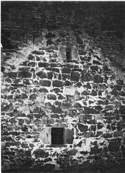
Sl. 3: Zgornji del vzhodnega pročelja, danes pod streho vzhodnega prizidka. Spodaj je okno, zgoraj dimna lina; dobro je viden stik nadzidave in prvotnega zatrepa. – Foto Božidar Premrl.
