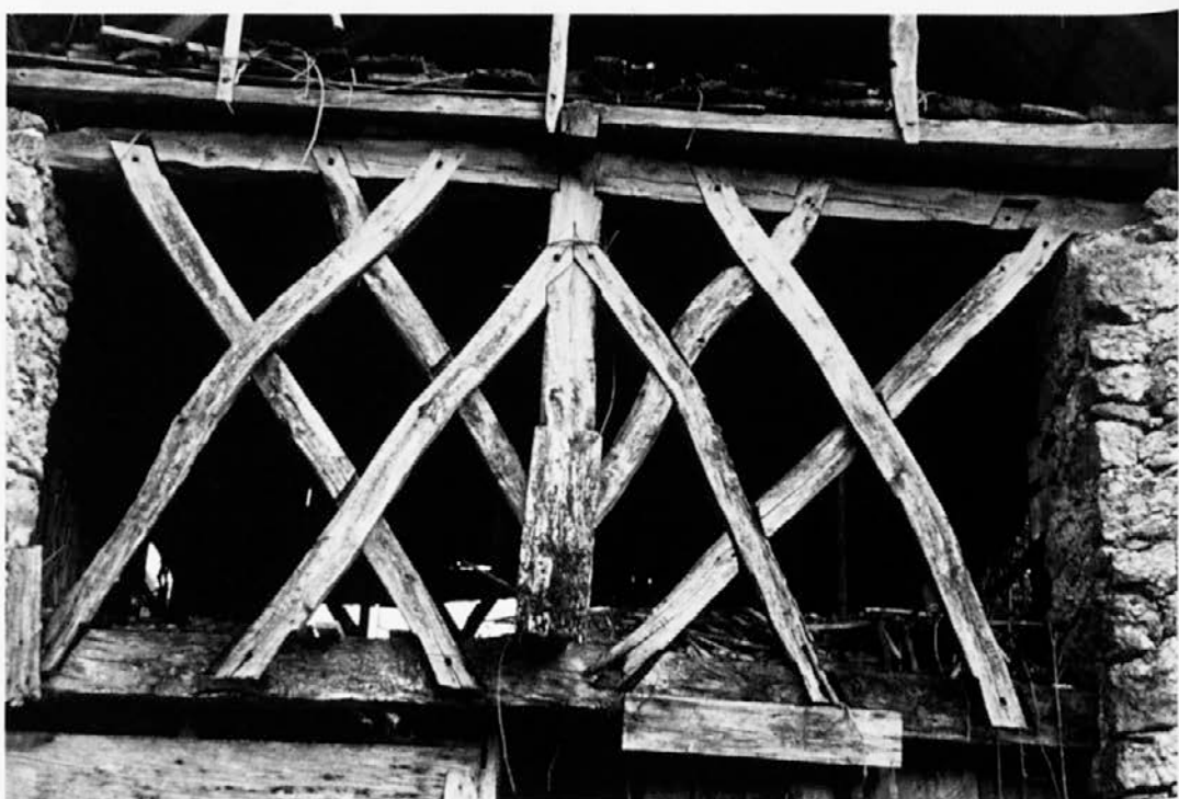
Sl. 14: «Križi», stesani iz lesa listavcev, zapirajo nadstropni del čela kozolca in povezujejo lesene dele konstrukcije stavbe (foto: T. Cevc, 2001)
