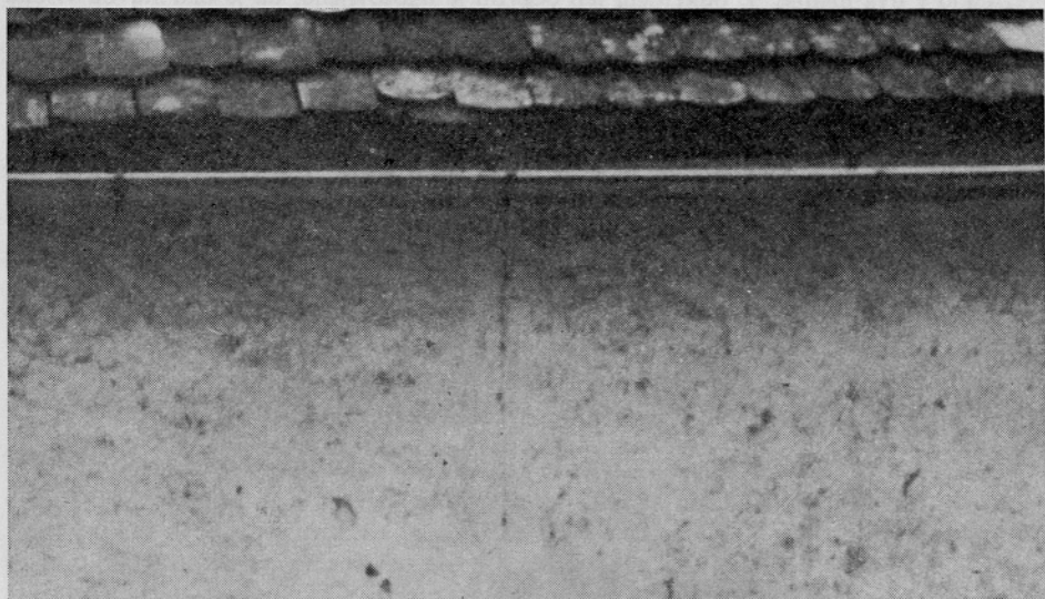
Sl. 1. Martinova kapela. Razpoka, kjer se stikata ladja in prezbiterij Fig. 1. La chapelle de St. Martin. La fissure, où se touchent la nef et le chœur
