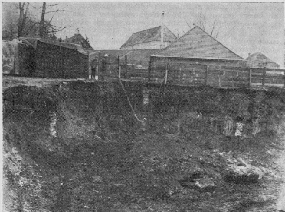
Sl. 5: Ptuj, Vičava 1975 — temelja zidov najmlajše gradbene faze v severovzhodnem in jugovzhodnem profilu izkopa.
