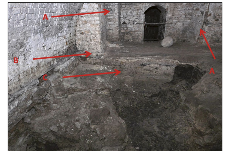
14. Posen, ehemalige Jesuitenkirche, Keller unter dem vierten Joch des Mittelschiffes in Richtung Osten (A – Pfeilerunterbau; B – Säulenunterbau; C – Steinschichten)
