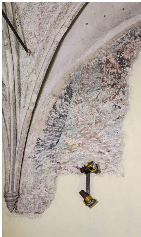
9. Slovenske Konjice, župnijska cerkev sv. Jurija, severna kapela, dve plasti poslikave na severni steni vzhodne traveje (© ZRC SAZU, foto: Andrej Furlan)
